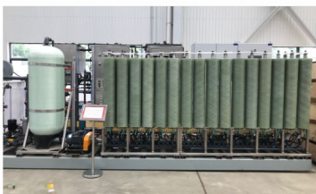
固定式渗滤液处理站
